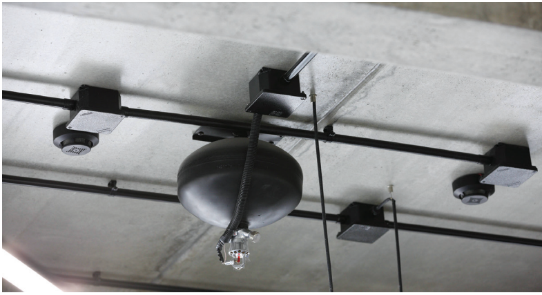
Заправочні станції «Socar». Підключення систем пожежогасіння відповідно до вимог ДСТУ кабельною лінією з вогнестійкістю Р90 Socar gas stations. Fire extinguishing systems are connected with P90 cable line in accordance with the requirements of National Standard of Ukraine
