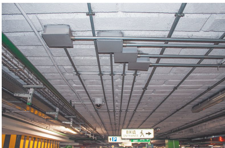
Паркінг ТРЦ «Ocean Plaza». Кабеленесучі системи із захистом IP67 Ocean Plaza parking. IP67 cable support systems
