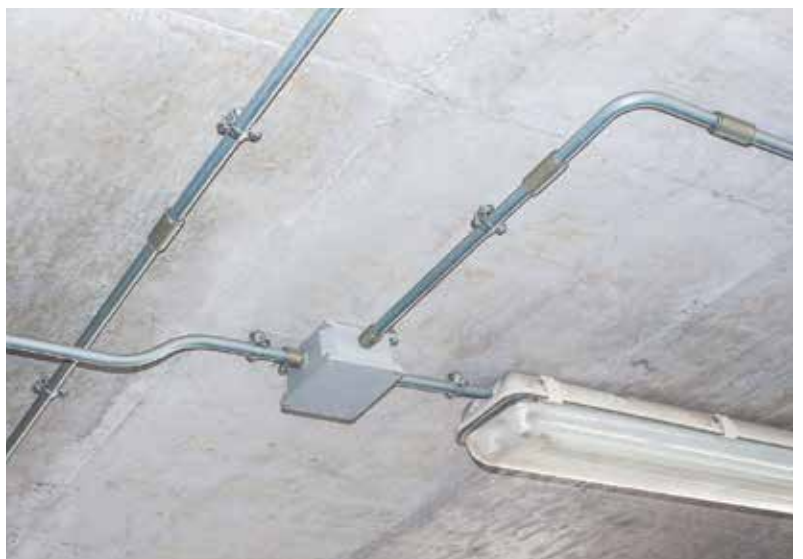
Організація освітлення в підвальному приміщенні. Згідно ПУЕ 6.2.2 Basement lighting arrangement. According to EIC 6.2.2
