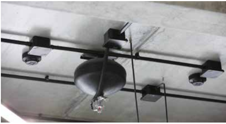
Підключення систем пожежогасіння відповідно до вимог ДСТУ кабельною лінією з вогнестійкістю P90 Fire extinguishing systems are connected with P90 cable line in accordance with the requirements of National Standard of Ukraine
