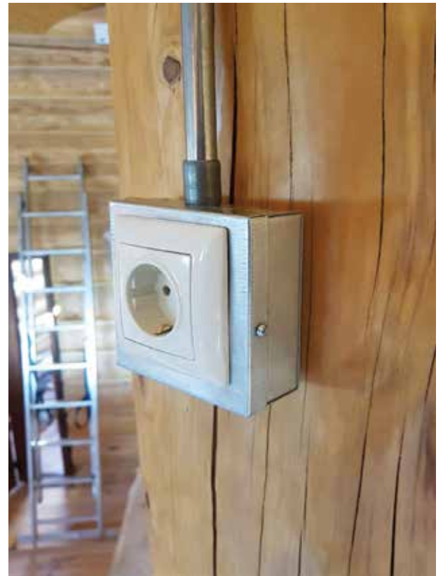
Котеджне містечко. Монтаж кабельних систем по легкозаймистим конструкціям відповідно до вимог ПУЕ Cottage town. Installation of cable systems on combustible structures in accordance with the EIC requirements
