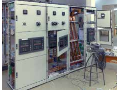
Комутація в шафах управління промисловим обладнанням Switching in control cabinets for industrial equipment
