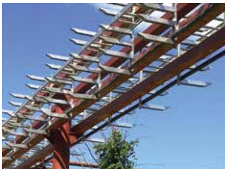
Електричні мережі. Electrical networks.
