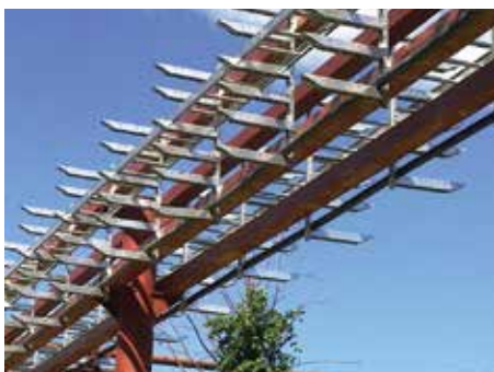
Електричні мережі. Electrical networks.
