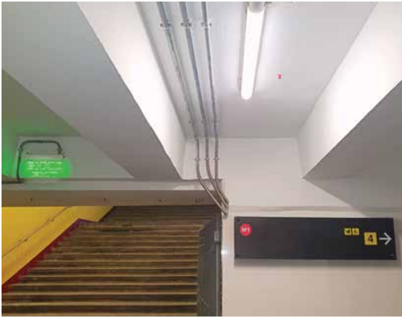
Побудова вандалостійкої мережі освітлення та сповіщення Construction of a tamper-proof lighting and public-address system
