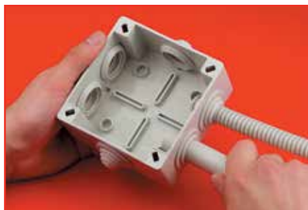
Етап 2. Введення гофрованої і жорсткої труби Step 2. Insertion of corrugated and rigid pipes
