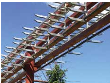
Електричні мережі. Electrical networks.
