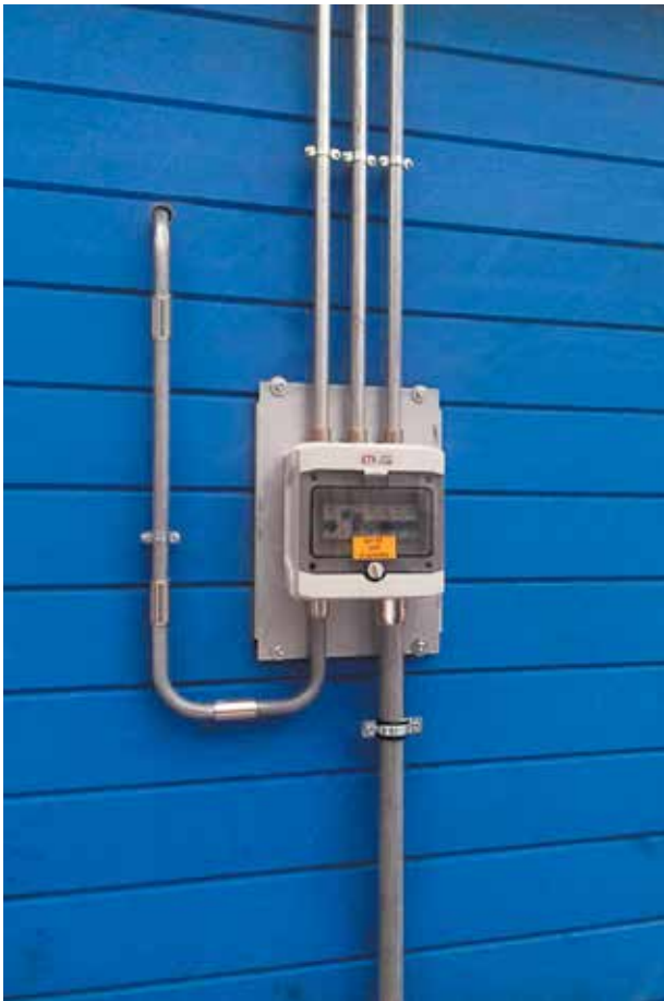
Монтаж кабельної системи згідно вимог ПУЕ 2.1.19 Installation of cable system according to the EIC 2.1.19 requirements
