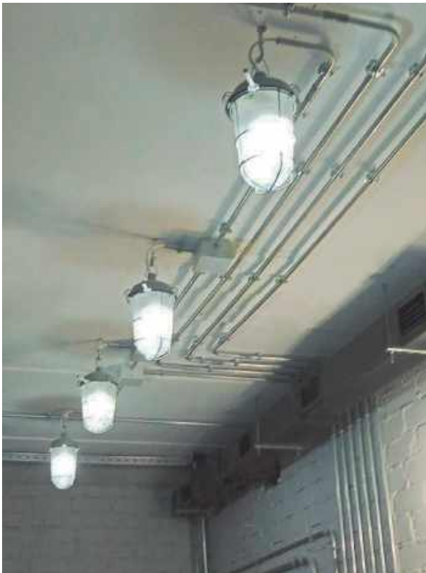
Освітлення офісного коридору. Дизайнерське рішення в стилі «Лофт» Office corridor lighting. Loft design
