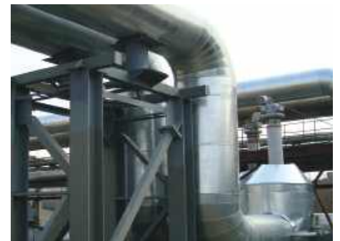
Системи вентиляції, кондиціонування та трубопроводи. Ventilation and air conditioning systems and pipelines.
