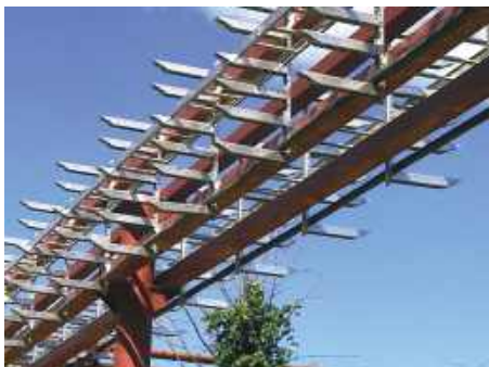
Електричні мережі. Electrical networks.
